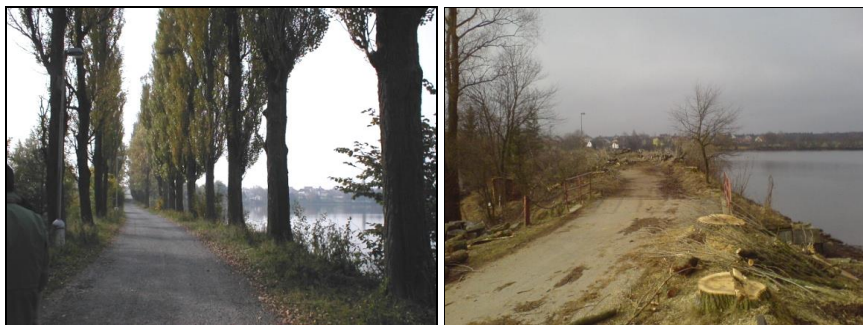
Obr. 1. Alej nevhodných topolů na koruně (vlevo); pařezy – doklad poškození stromů (vpravo).
