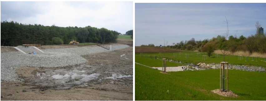
Obr. 5. Zpevnění návodní strany hráze (vlevo); nově vysázená vegetace v okolí rybníka (vpravo).
