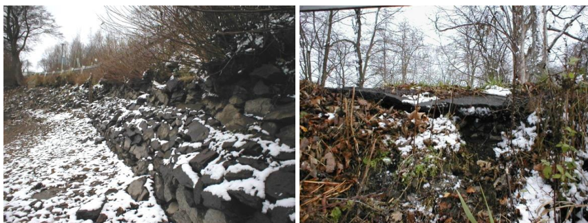
Obr. 3. Taras porušený zatížením vozidly (vlevo); sesutá krajnice nad porušeným tarasem (vpravo).
