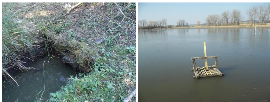
Obr. 6. Nízká hladina v trubní jámě (vlevo); výpust rybníka – čap (vpravo).
