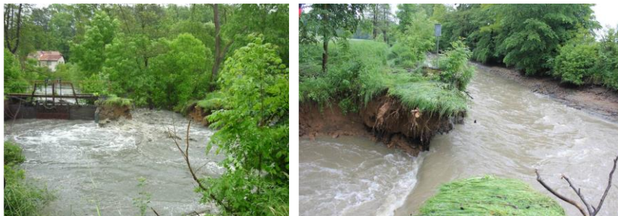
Obr. 8. Rybník Zájezdek – pohled na sdružený objekt a protržené místo v tělese hráze a pohled na vytvářející se průrvu v tělese hráze (2. 6. 2013)
