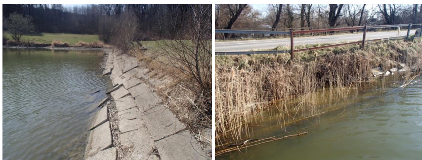
Obr. 4. Sesuté betonové panely (vlevo); sesuv silnice nad porušeným opevněním (vpravo).
