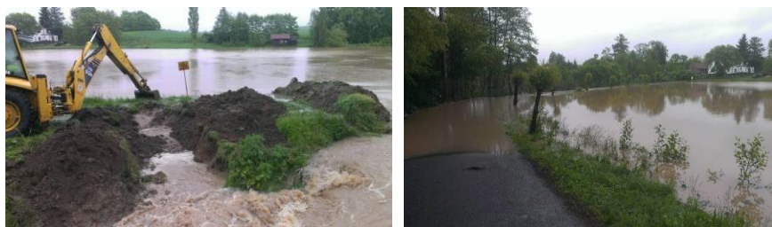
Obr. 9. Chotouchovský rybník – prohrábka dělicí hráze při nástupu povodně a pohled na přelévající se hlavní hráz
