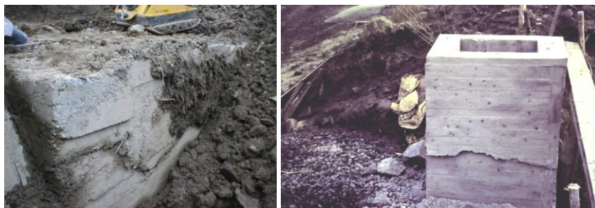
Obr. 7. Nedodržený sklon, přetoky a ponechané bednění ve spodní části konstrukcí.
