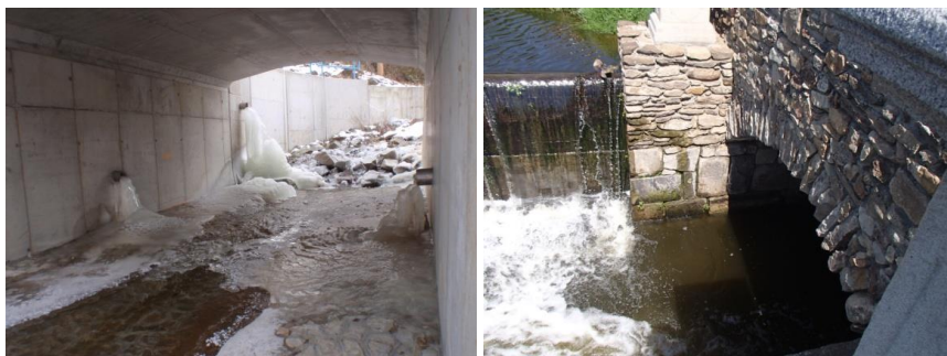
Obr. 11. Chybně navržená konstrukce (vlevo); správně řešená replika historického mostu (vpravo).
