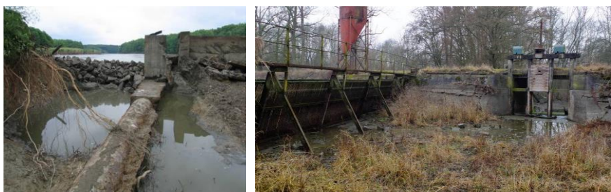
Obr. 6. Komárovský rybník – pohled proti vodě do kamenným zásepem částečně zatarasené průrvy v profilu spodní výpusti a hlavní hrazený bezpečnostní přeliv v pravém zavázání s 20 m dlouhou česlovou stěnou.
