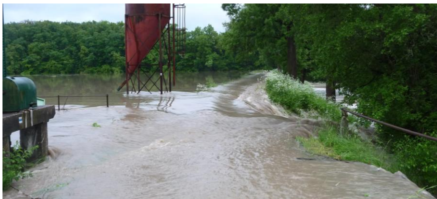
Obr. 5. Komárovský rybník – voda přepadající přes korunu hráze 2. 6. 2013 ve 20:00 hod., přibližně 6 hodin před kulminací
