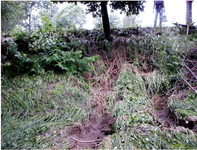
Obr. 1 Výmol za kmenem vytvořený vodou přetéající přes korunu hráze při povodni.
