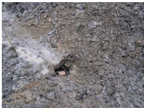
Obr. 5 Porucha na špatně provedeném napojení potrubí
