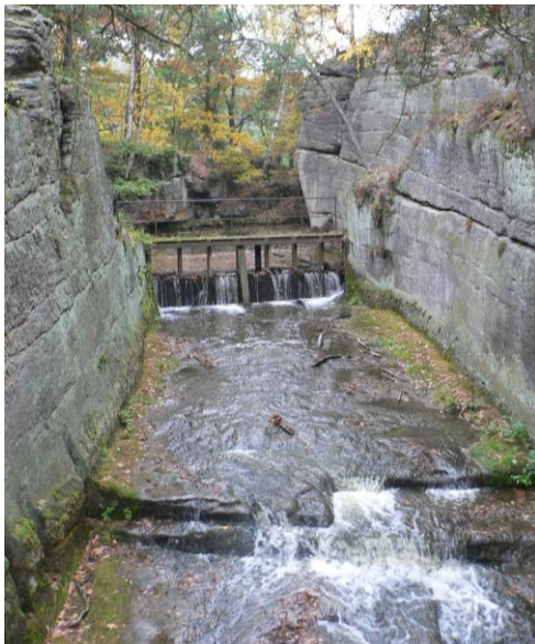
Obr. 7 Mlýnský rybník, stav průřvy staré výpusti před povodní 2010, pohled z mostku ke stavidlům, foto M. Kolka 2008.
