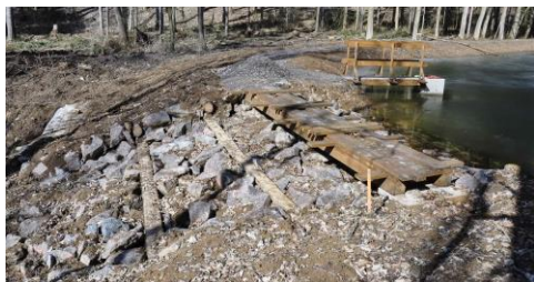
Obr. 6 Přímý, lichoběžníkový přeliv – rovnanina z lomového kamene stabilizovaná dřevěnými pasy (foto autor)
