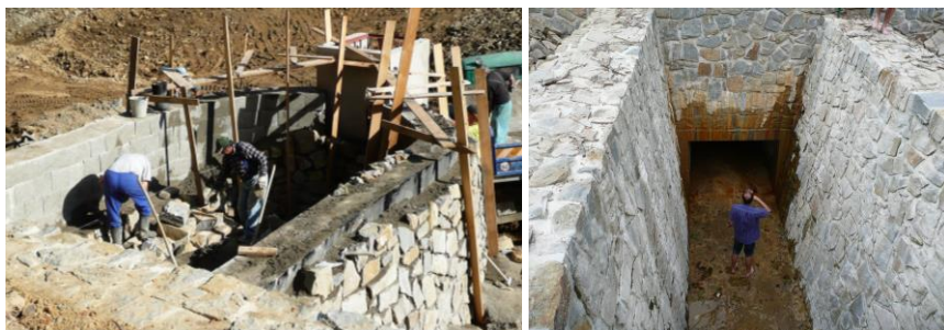
Obr. 9 Příklad selhání zhotovitele – konstrukce dle PD měla být provedena jako betonový monolit s kamenným obkladem ve formě ztraceného bednění. Zhotovitel použil betonové prefabrikáty prosypané zavadlou směsí cementového potěru, které následně obkládal k vrstvě izolace (vlevo, foto autor); výsledek konání zhotovitele již při napouštění nádrže (vpravo, foto autor)
