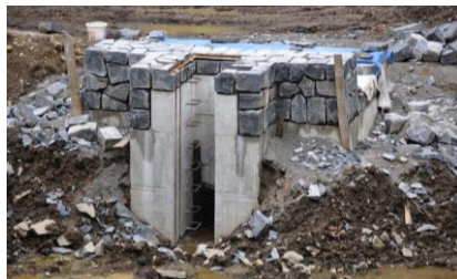
Obr. 3 Sdružený objekt - betonová monolitická konstrukce s obkladem – pohled z prostoru nádrže (foto autor)
