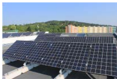
Fig. 2 The photovoltaic power station Kamínky (Photo: Doskočilová)
